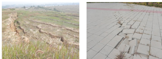
图8 煤矿1附近地面沉陷实地调查照片
